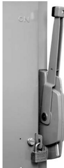
FIG. 10 : Padlocking the door Bloqueo de la puerta con candado Cadenassage de la porte
